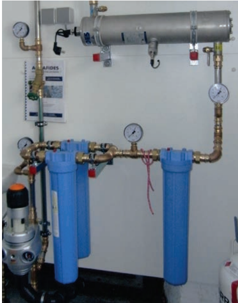
Abbildung 5-21: Kombination aus spülbarem Vorfilter, zweistufigem Feinfilter und UV-Desinfektion auf der Meilerhütte. Quelle: Wiesböck
