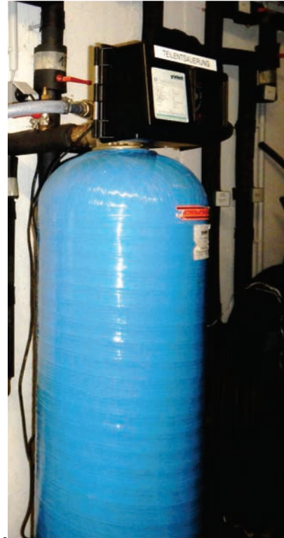
Abbildung 5-23: Geschlossener Filter zur Teilentsäuerung
