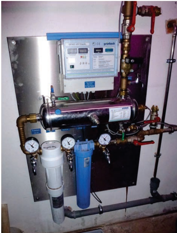
Abbildung 5-20: Zweistufige Partikelentfernung vor UV-Anlage. Quelle: DAV
