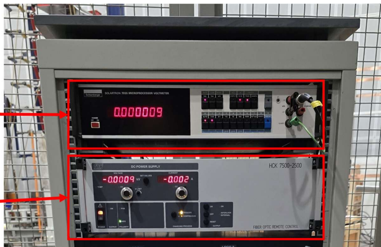
Bild 9.5 Fernsteuerung des Ladegeräts und das darüber installierte Digital-Voltmeter für die Kontroll-Spannungsmessung
