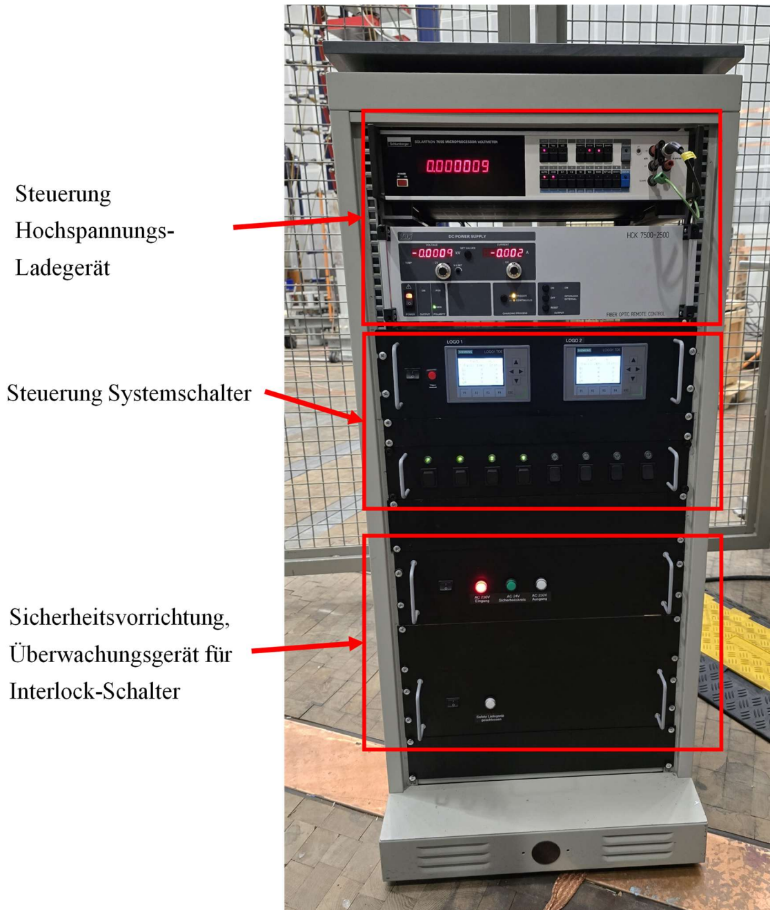
Bild 9.2 19“-Schaltschrank mit den Komponenten zur Steuerung des Hochspannungs-Ladegeräts und der Systemschalter und zur Gewährleistung der Sicherheit des Langzeitstrom-Generators
