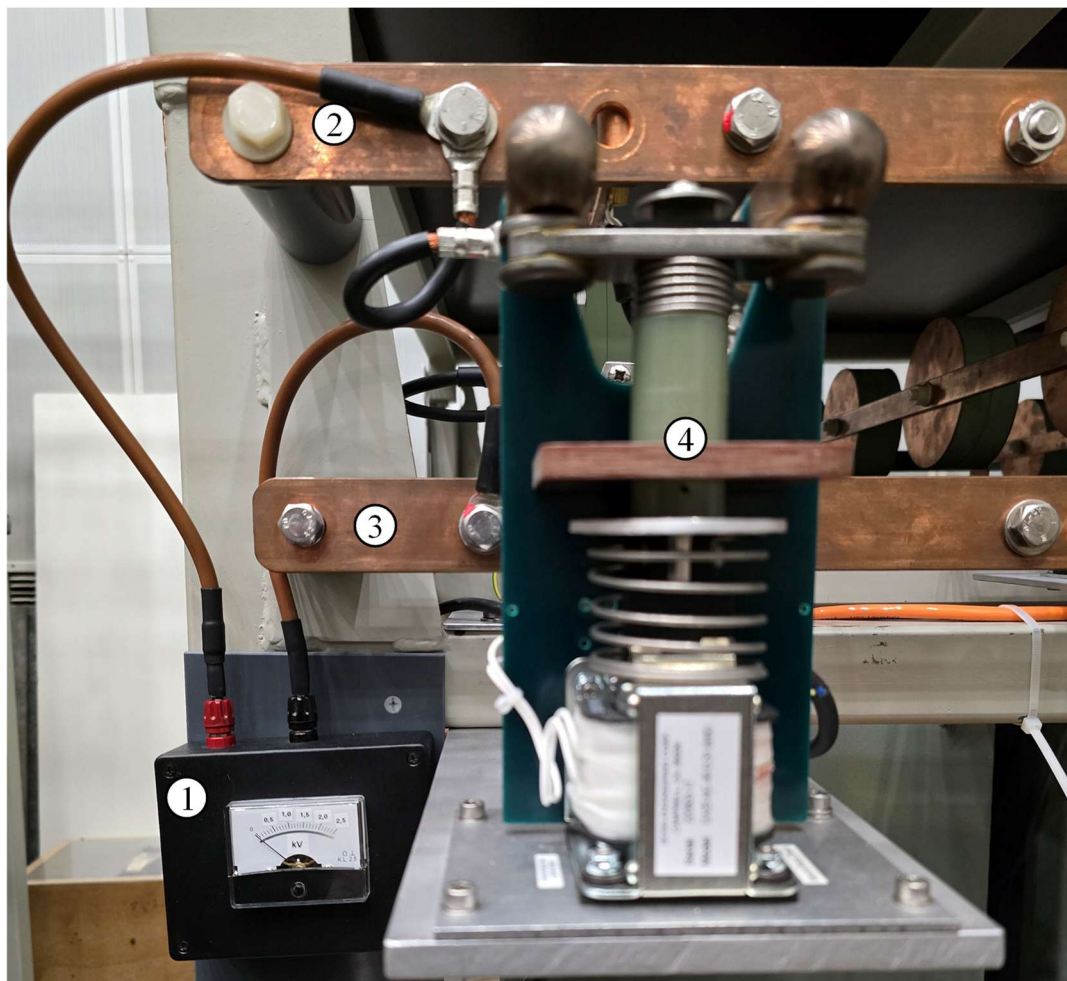
Bild 7.9 Spannungsanzeige neben dem Erdungsschalter eines Kondensator-Moduls
