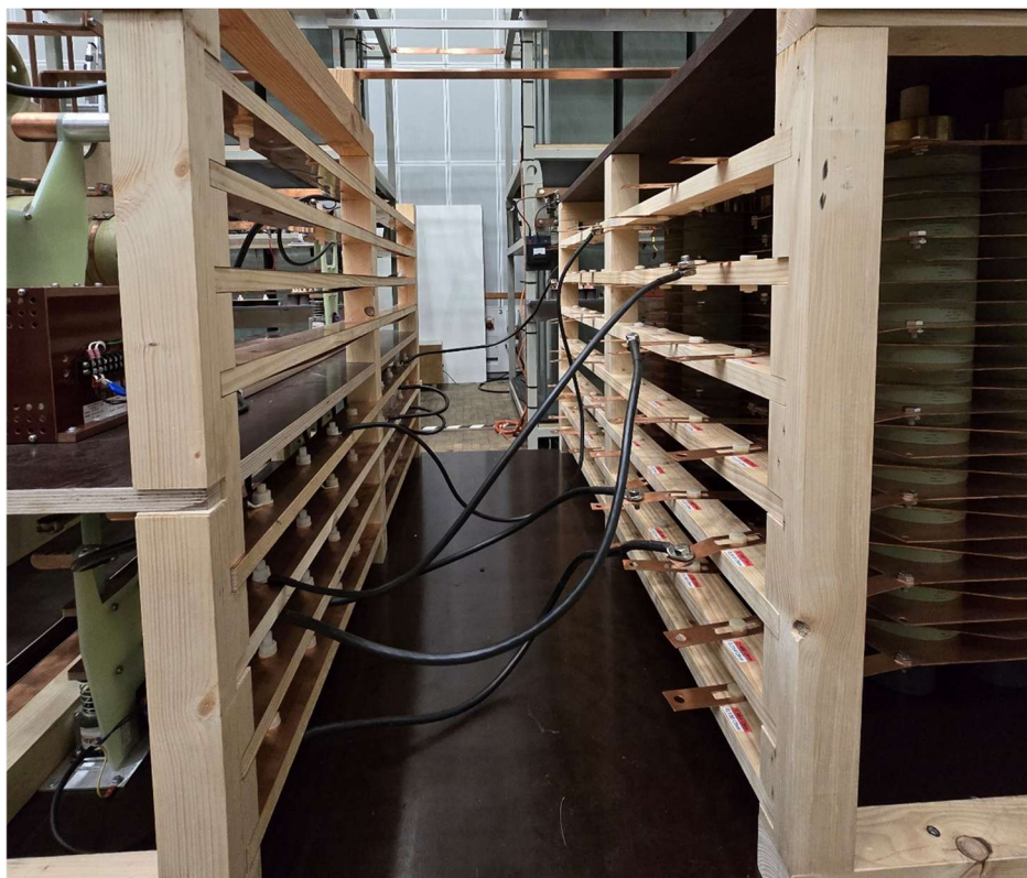
Bild 7.21 Verbindungsbereich mit angeschlossenen Verbindungsleitungen zwischen Schaltschiene und Verteilerschiene
