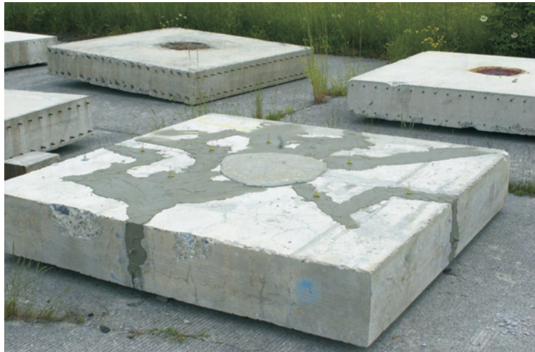
Abbildung 7.23: Geschädigte Stahlbetonplatte, vorbereitet zur Injektion
