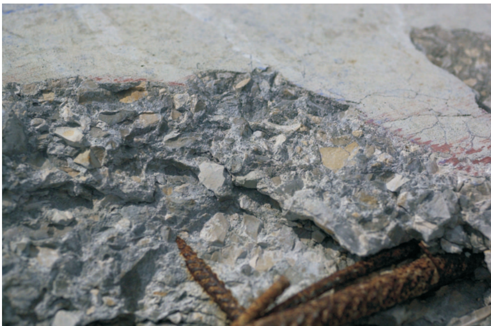
Abbildung 5.9: Schollenbildung aufgrund der Querschnittsschwächung durch die Bewehrung
