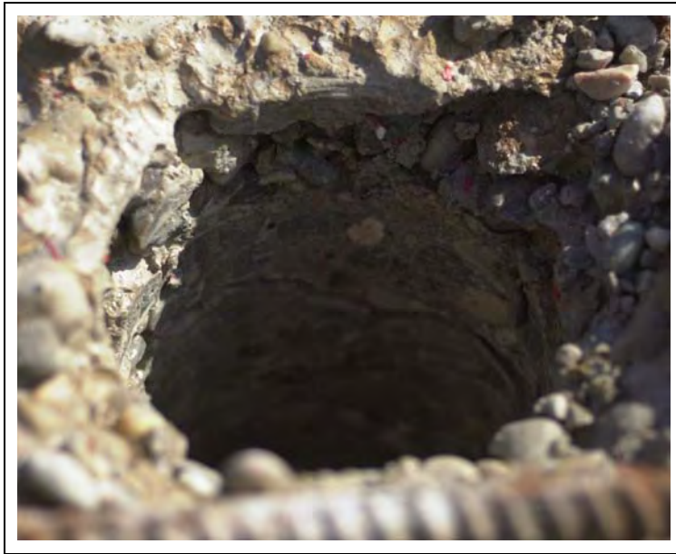
Abb. B.1.8: Detailansichten Wandung Nr. 2 Platte WTD 2 (Fortsetzung)
