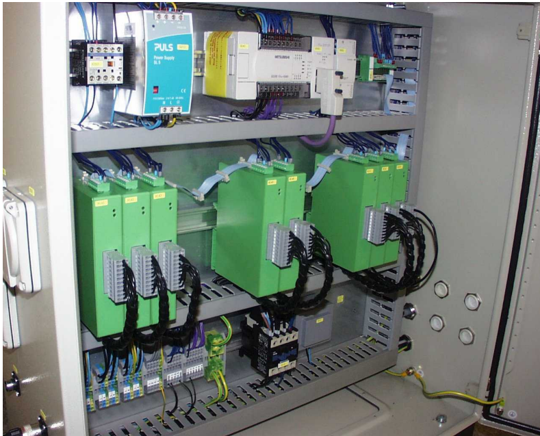
Abbildung 21: Schaltschrank für die CIPASS Lichtbogenzündung (Konzept: UniBw München, Industrielle Fertigung: Firma REGATRON, Schweiz).
