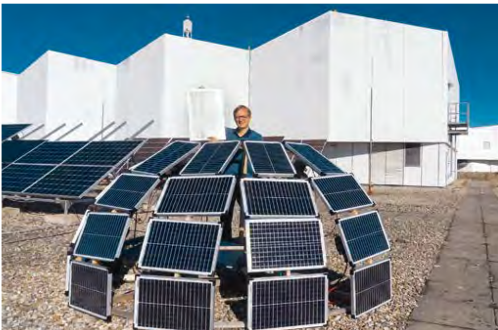
Im Rahmen eines Studierendenprojekts unter Leitung von Dr. Eckerle (Bild) entstand eine platzsparende PV-Anlage in Iglu-Form
