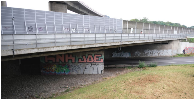
Bild 2 Ansicht der Spannbetonbrücke am Autobahnkreuz Köln-Ost (Baujahr 1973), die mit weiterer Sensorik ausgestattet werden soll
