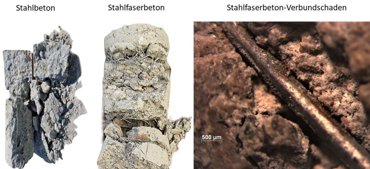
Abbildung 5-106: Bohrkernbilder aus dem unmittelbaren Ansprengbereich (aufgelöstes Betongefüge)
