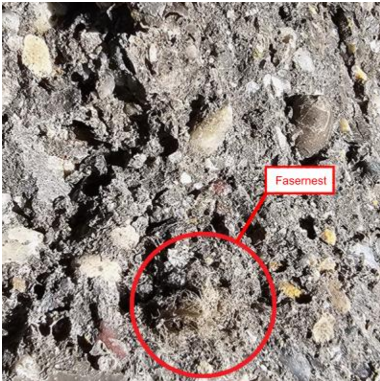
Abbildung 72 – Fasernest in der Bruchfläche eines Ökobetons
