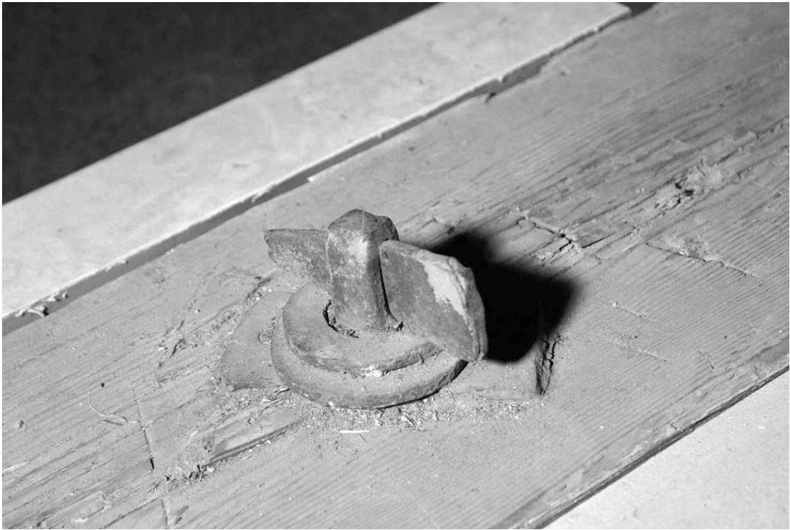
Abb. 2.26: Pfarrkirche Mittenwald (Tab. A.19). Eisenbolzen mit Beilagscheibe und Splint. Weitere Beilagscheiben mussten aufgrund des transversalen Schwindens des Holzes eingefügt werden
