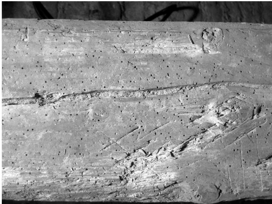
Abb. 3.3: Insektenbefall (Anobien: Gewöhnlicher Nagekäfer) an einem Kehlbalken des Dachwerks der Pfarrkirche Tunttenhamen
