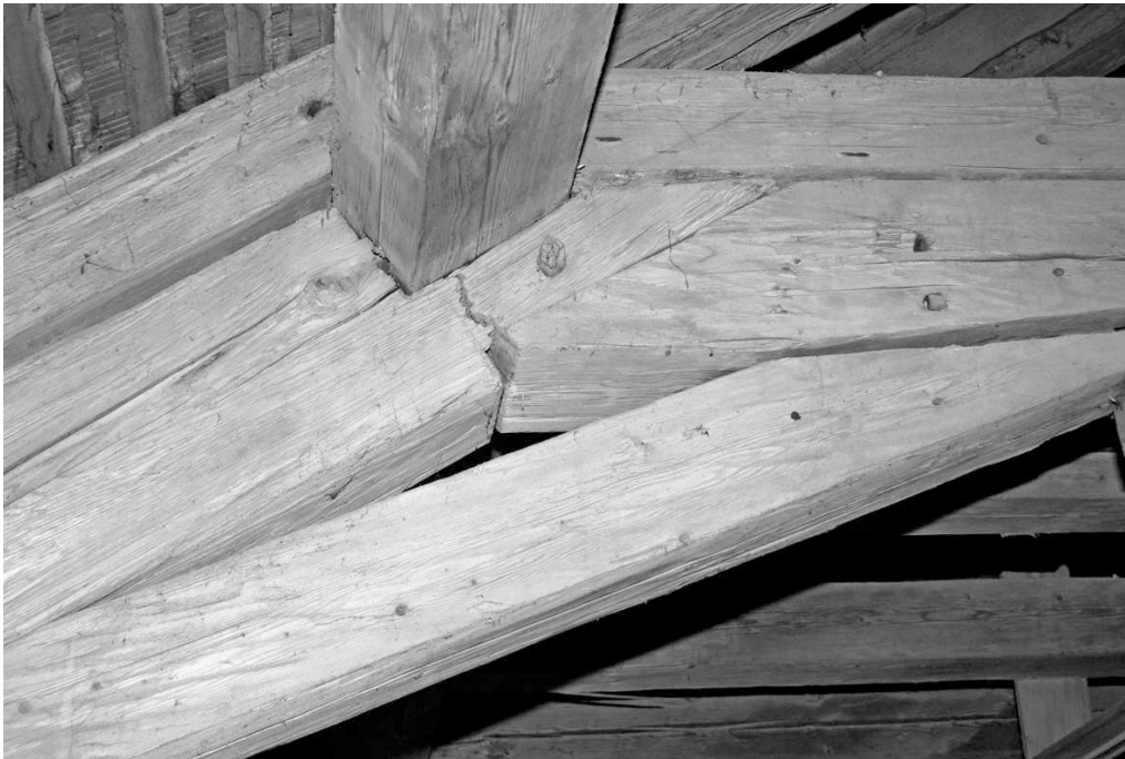
Abb. 3.4: Biegebruch im Dachwerk von Schloss Schleißheim infolge mechanischer Überlastung
