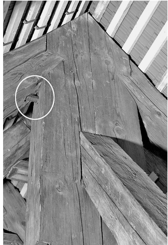
Abb. 2.38: Augsburg, ev. St. Ulrich. Oberer Anschluss der zangenartig verdoppelten Hängesäule mit einem Eisenbolzen an die Sparren
