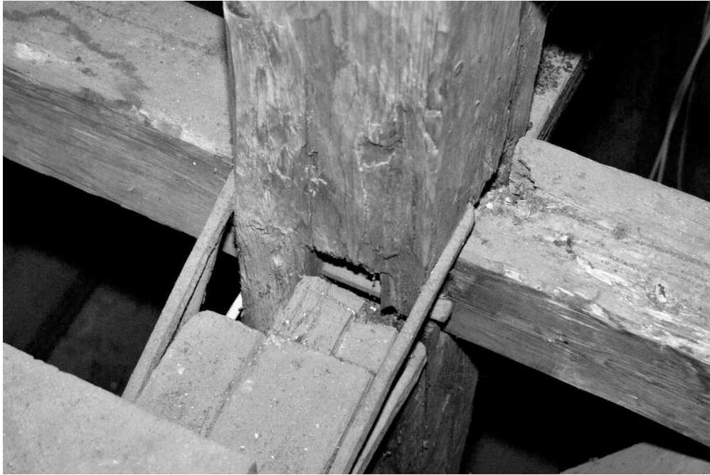
Abb. 2.32: Ausgerissene Zapfenverbindung des horizontalen Balkens zwischen den hohen Stuhlsäulen im Dachwerk der Pfarrkirche Tunttenhamen
