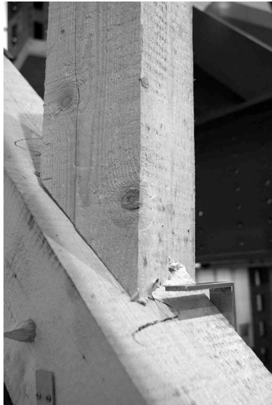
Abb. 4.21: Probe 04: Rissbildung am Vertikalbalken (Versagensmodus 2)
