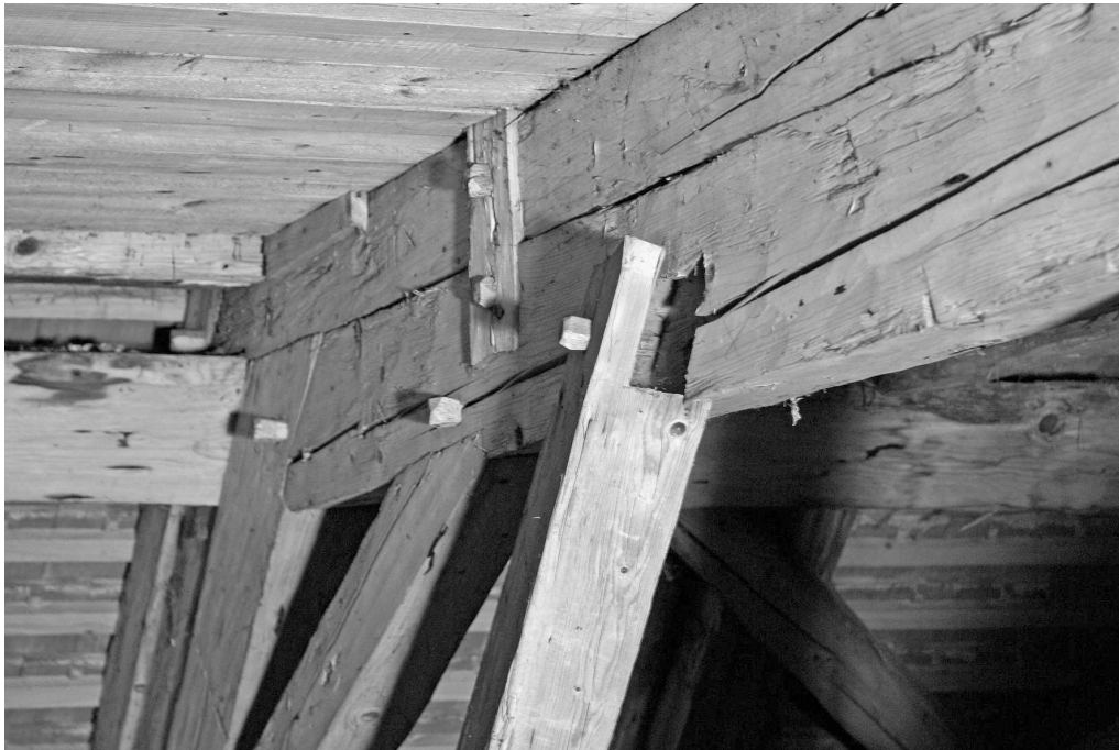
Abb. 3.5: Ausgerissene Anblattung infolge Schwindens und Drehwüchsigkeit im Dachwerk der Pfarrkirche Baumburg
