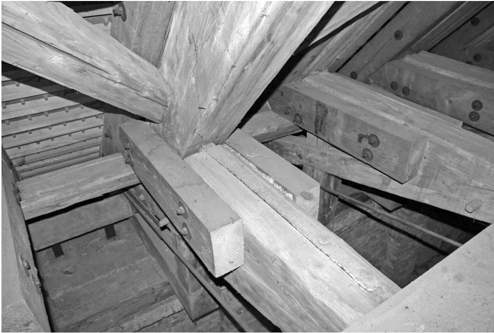
Abb. 2.47: Anschluss der erhöhten Zerrbalkenlage an die Sparren mit Durchsteckzapfen und Eisenband im Altenerdinger Dachwerk
