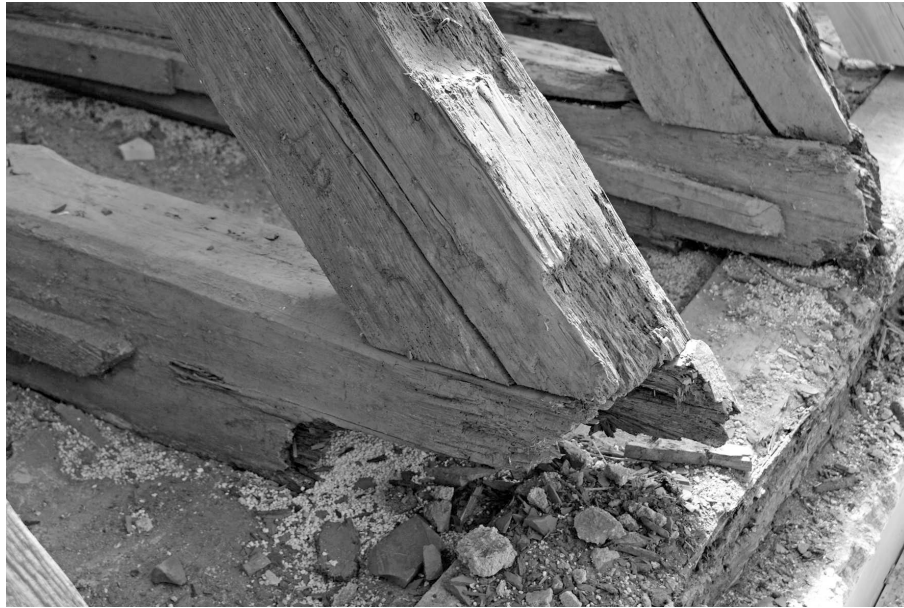
Abb. 3.2: Fäuleschaden an den Sparrenfüßen des Dachwerks über dem Klostergäude von Beyharting infolge von Durchfeuchtung
