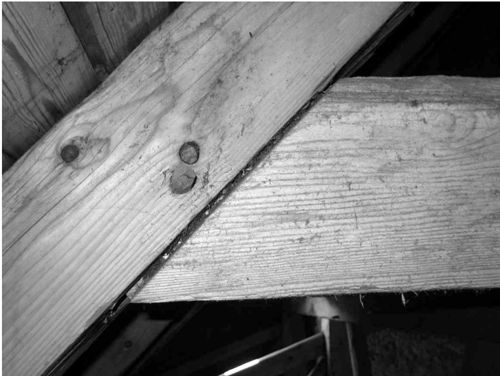
Abb. 3.29: Klaffung zwischen Sparren und Kehlbalken im Dachwerk der Pfarrkirche Weyarn
